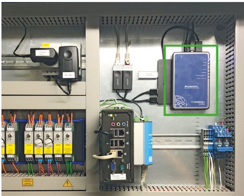
Bild 4. Die VK Box ist die Kommunikationsschnittstelle zur jeweiligen Erzeugungsanlage.
