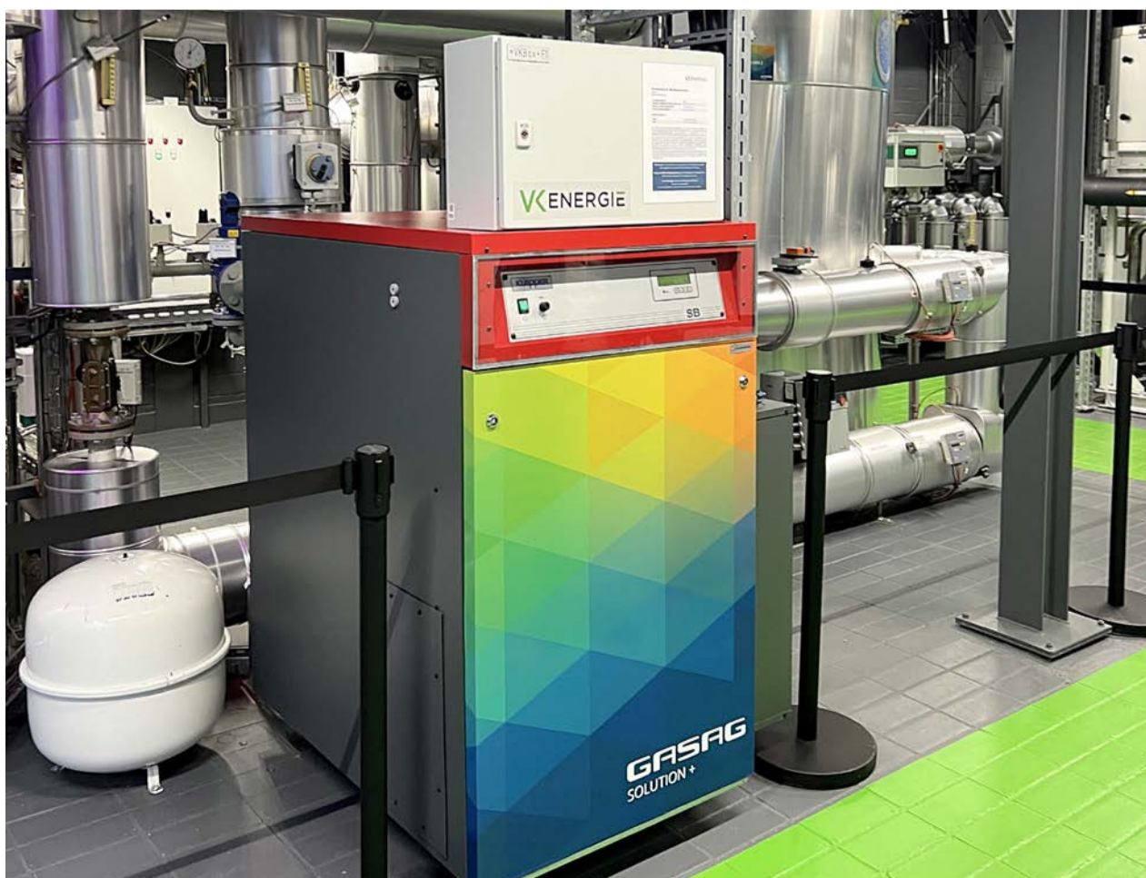
Eine VK-Box samt Wärmespeicher am Euref-Campus in Berlin. Die Anlage wird von der Gasag betreut
